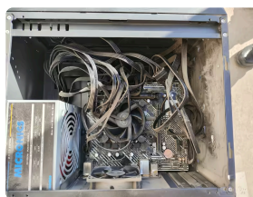
Antes Cables desordenados y polvo acumulado.
